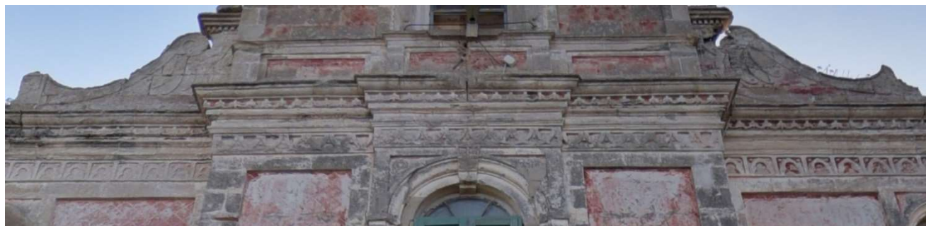
Figura 14 Degrado elementi decorativi
