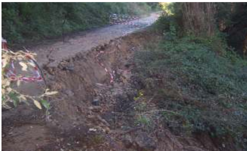
FIG. 6.1 – FRANA SULLA STRADA MILITARE DI COLLE – LITERNO (LOCALITÀ BUCA DI BOMBA – PORTOFERRAIO)
