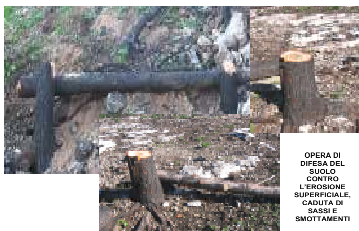
FIG. 9.1 – OPERE DI DIFESA DEL SUOLO CONTRO L'EROSIONE SUPERFICIALE, CADUTA SASSI E SMOTTAMENTI.
